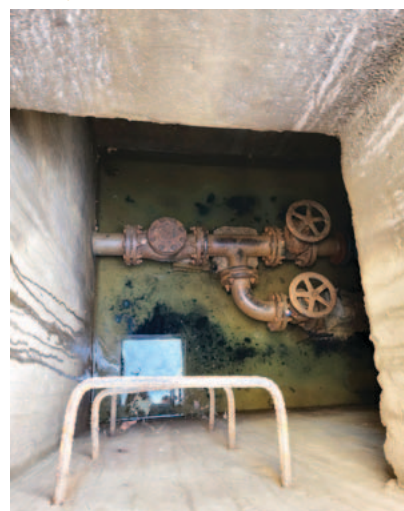
Nakupljanje oborinskih voda u oknu priključka na javnu vodoopskrbnu mrežu
