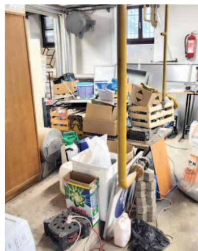
Nezadovoljavajući sanitarno-higijenski uvjeti u kotlovnici
