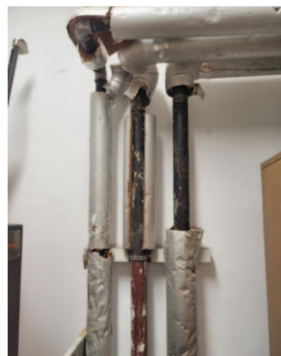
Oštećena izolacija na cijevima kućne vodoopskrbne mreže
